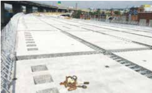
Figure 7. Pont du canal de Lachine (SOURCE DE LA PHOTO : KIEWIT, PARSONS AND CRH CANADA JOINT VENTURE)
