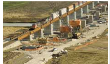
Above: Over the course of the project, 8 highway and railway bridges will be replaced to ensure that they are above the 1-in-700 year flood level. / La réalisation du projet donnera lieu au remplacement de 8 ponts autoroutiers et ferroviaires afin qu'ils soient à un niveau supérieur à celui d'une crue susceptible de se produire une fois en 700 ans.
